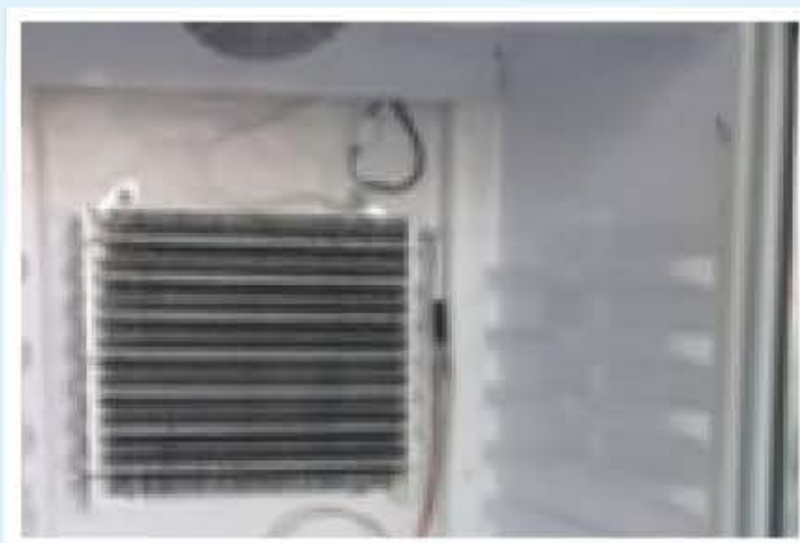
BLOWER SYSTEM COOLING FAN
